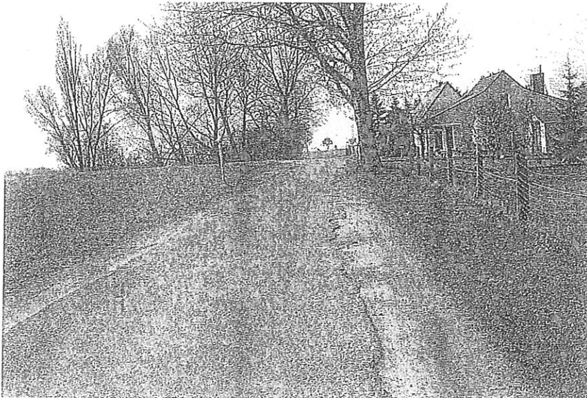
Abbildung 2: Weg im Abschnitt A, Ortslage Öftenhäven, starke Kantenabbrüche
